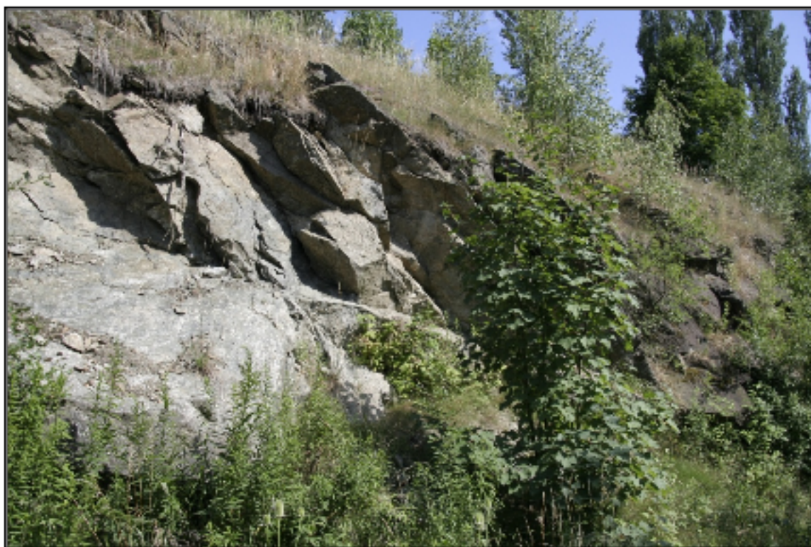
Obr. 10 – Část skalního svahu, jež se silničním mostem, východní svah, směr Křižanov, je zde viditelná potřeba očistění a oděžení nestabilních partií
