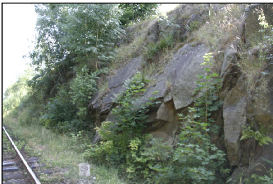
Obr. 19 – Část západního skalního svahu, pohled proti směru staničení, směr Studenec, nutnost očistění a oděšení volných kamenů a bloků, odstranění vzrostlé vegetace, případně lokální kotvení větších bloků
