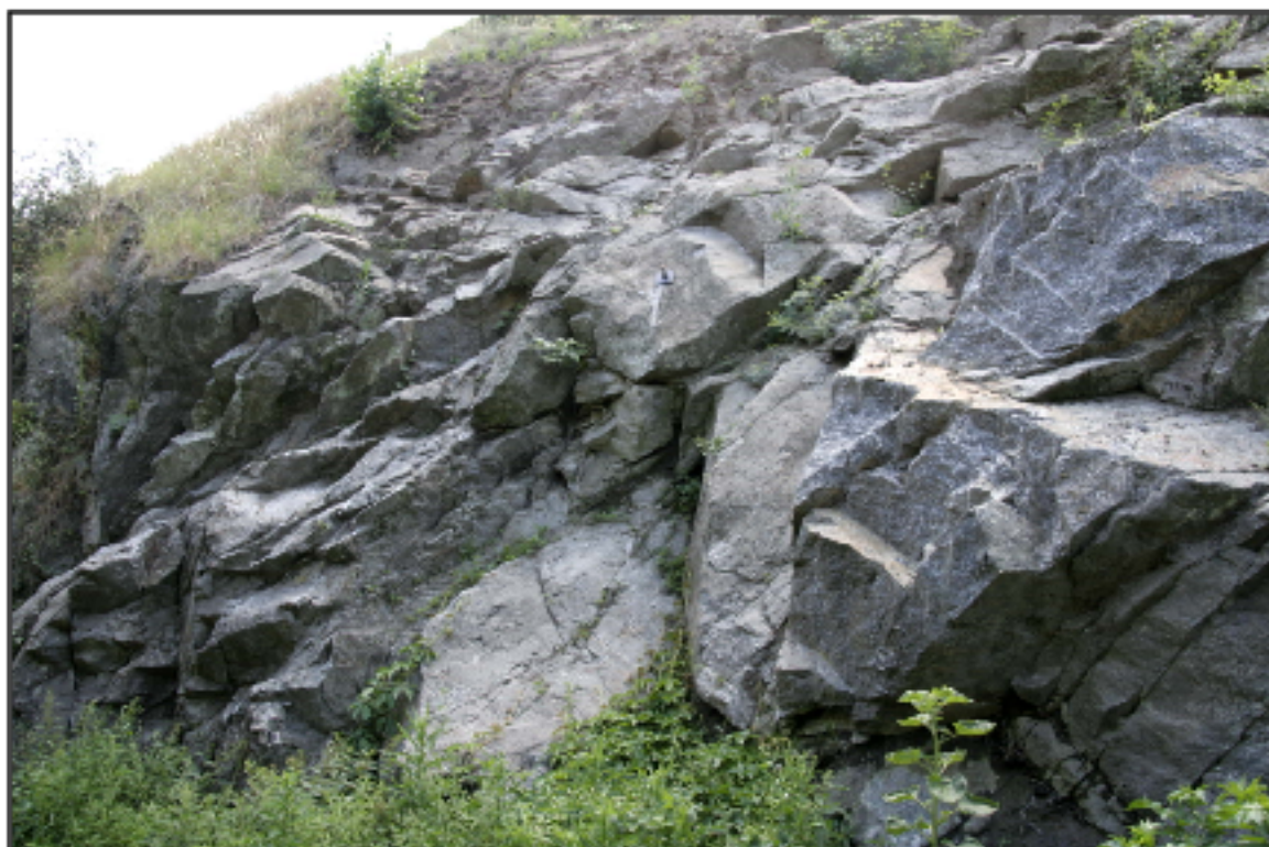
Obr. 15 – Pohled na část již západního skalního svahu, pohled proti směru stoupání, směr Studenec, možnost očištění a odštěpení volných kamenů a bloků, případně lokální kotvení větších bloků
