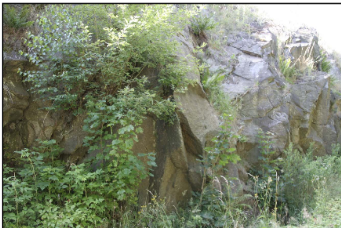
Obr. 18 – Pohled na část západního skalního svahu, již za silničním mostem, pohled směr Křižanov, je zde patrná nutnost očistění od volných částí involuční horniny a odstranění vzrostlé vegetace
