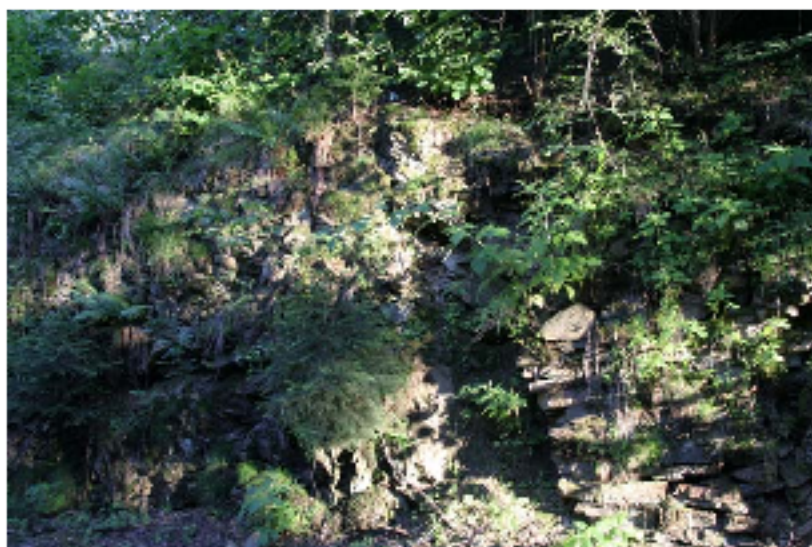
Obr. 5 Pohled na zcela zvětralou část zářezu
