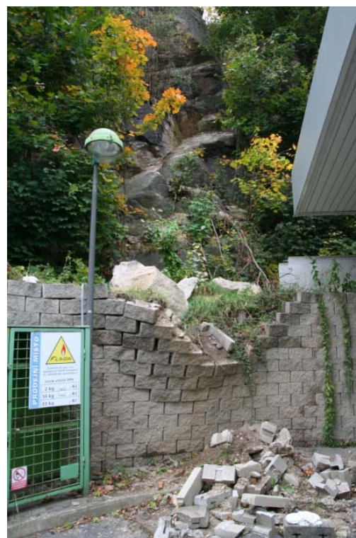
Obrázek 19: Poškození prostoru čerpací stanice v Liberci na ulici Milady Horákové
