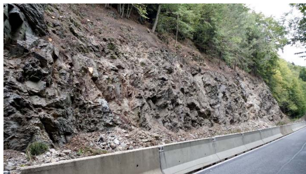
Obrázek 18: Skalní svah po provedení základního sanačního zásahu, sil I/10 u obce Splzov
