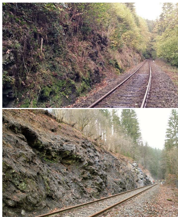
Obrázek 16: Pohled na skalní odřez u trati 042 - v úseku Poniklá - Jablonec nad Jizerou, km 14,3 - 14,4, nahoře před základním sanačním zásahem 2016, dole po základním sanačním zásahu 2016
