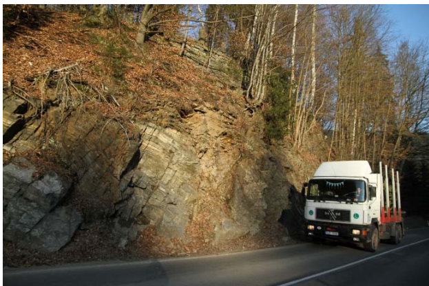
Obrázek 3: Nezajištěný skalní masiv ze silně narušených erlanů nad silnicí I/14 v Rokytnici nad Jizerou
