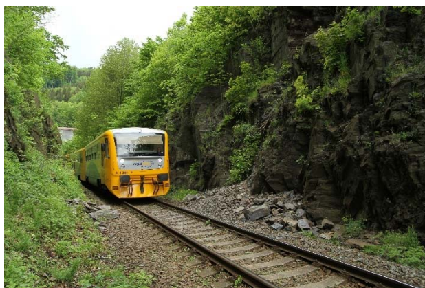
Obrázek 17: Trať 310 - Olomouc hl. n. - Krnov, průjezd osobního vlaku v zářezu po mimořádné události, kdy došlo k ohrožení a omezení ohroženého prostoru trati v km 17,670 - 17,740
